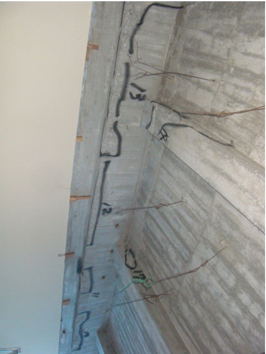
興津町民館 躯体コンクリート劣化状況②
