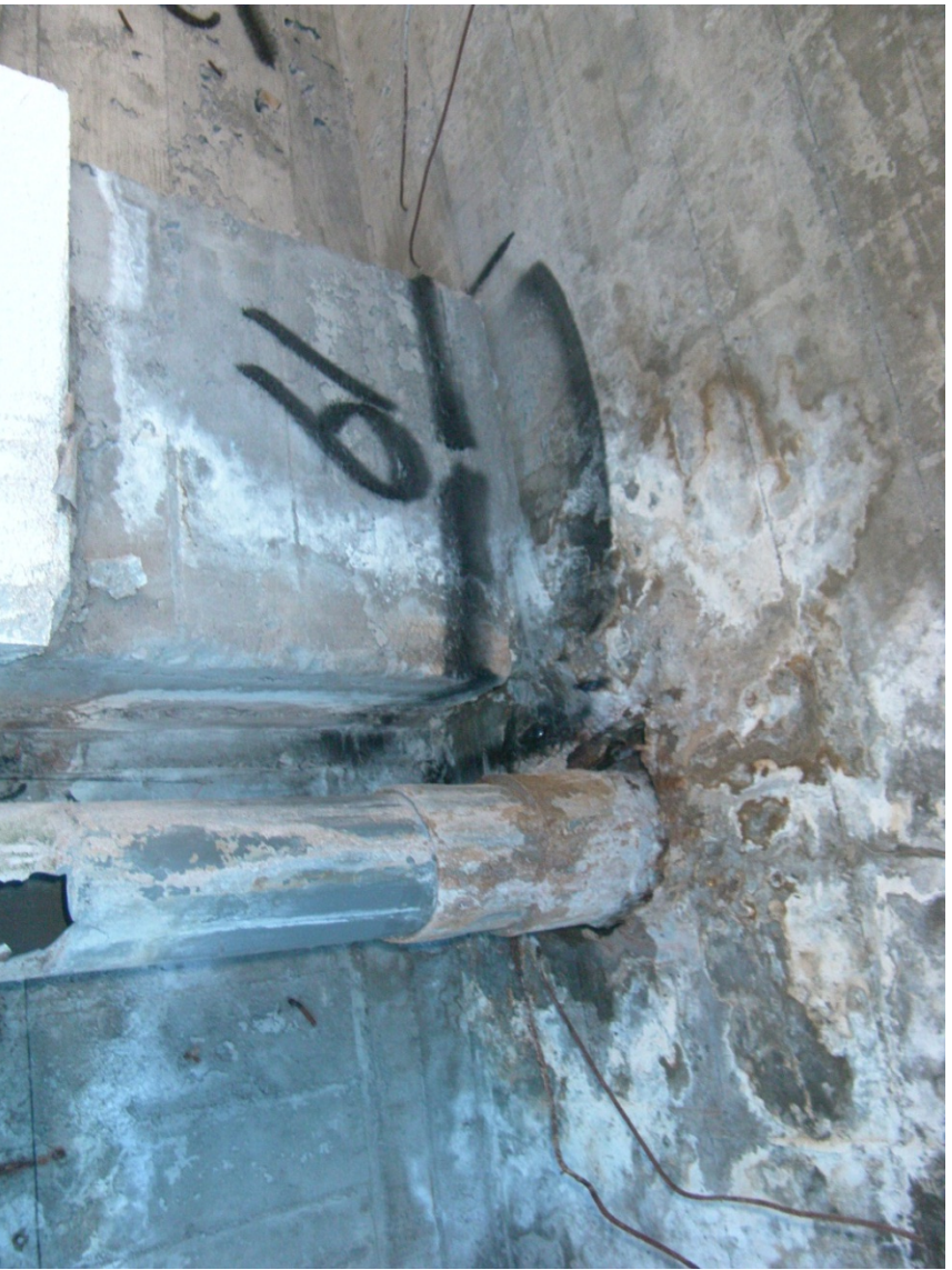
興津町民館 躯体コンクリート劣化状況③
