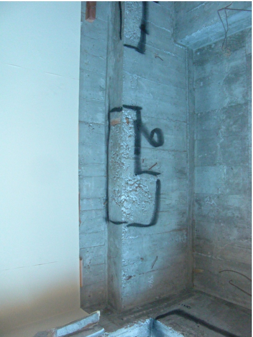
興津町民館 躯体コンクリート劣化状況①
