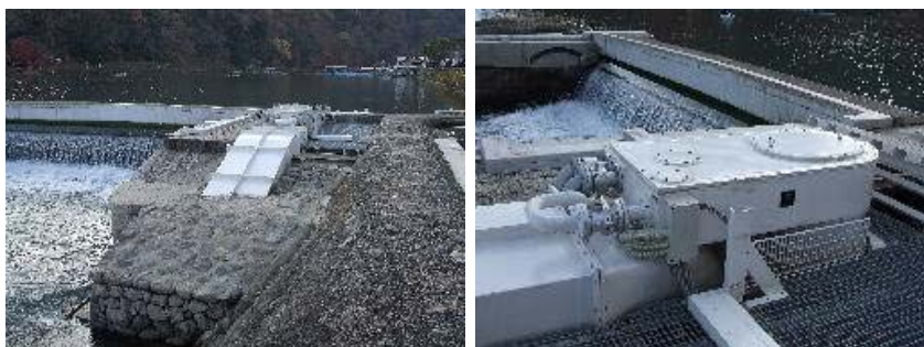
嵐山保勝会水力発電所（一級河川桂川）
