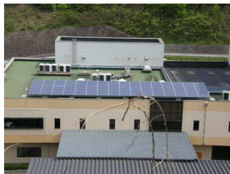
環境管理事務所クリーンセンター銀河の太陽光発電設備
