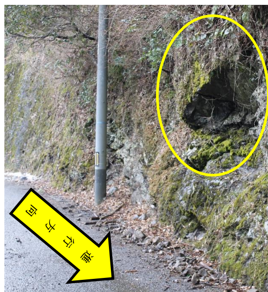
〔落石発生現場〕
