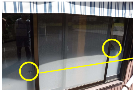
〔損傷部位：窓ガラス2枚〕
