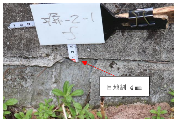
【事後】ブロック塀（目地割 4mm） （振動により隙間が 3mm 拡大）
