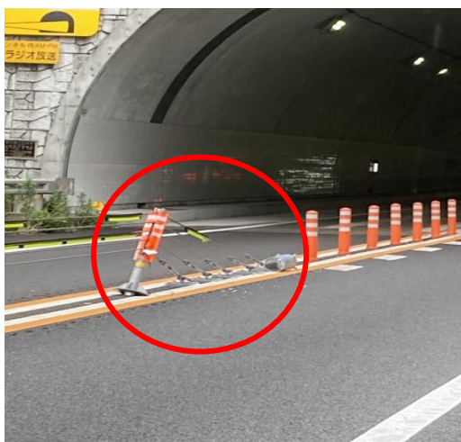
＜道路附属物損害＞
