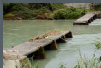
若井沈下橋は橋桁と橋脚が流失。
