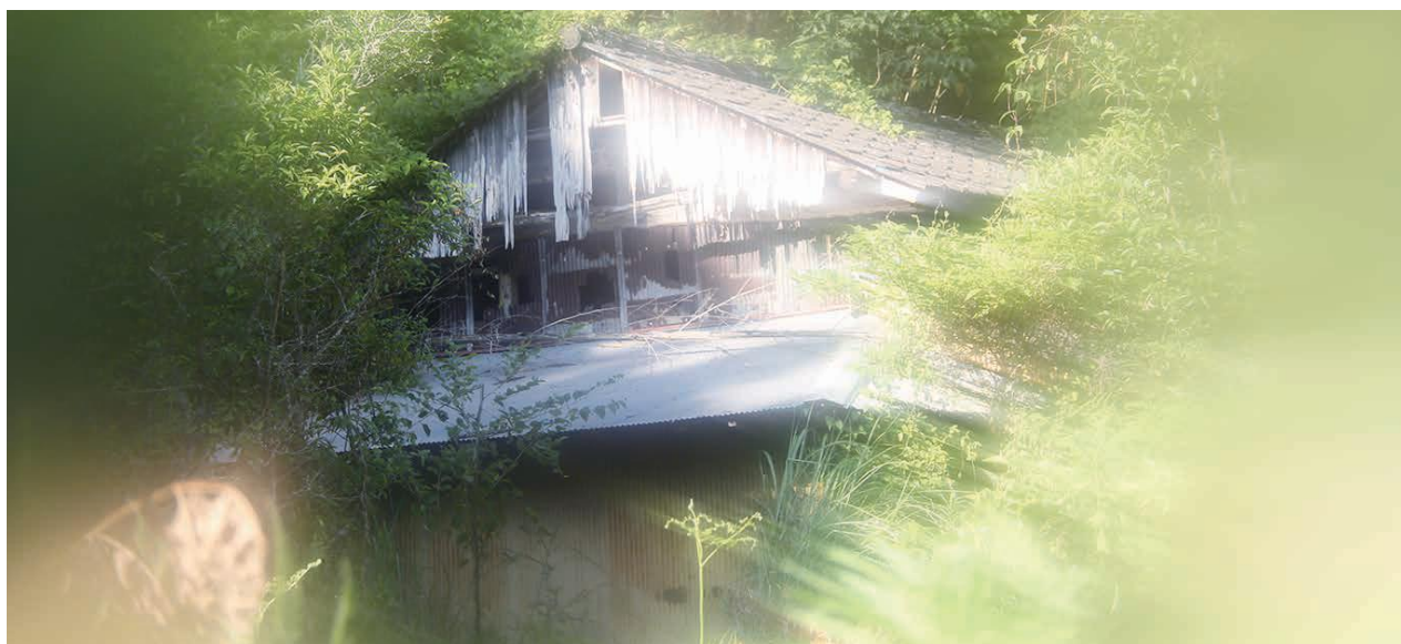
対策が急がれる危険な建築物
