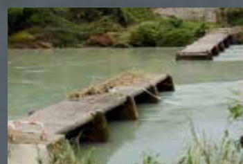
若井沈下橋は橋桁と橋脚が流失。
