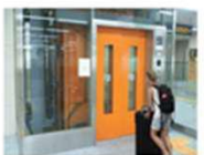
段差解消 (エレベーター)
