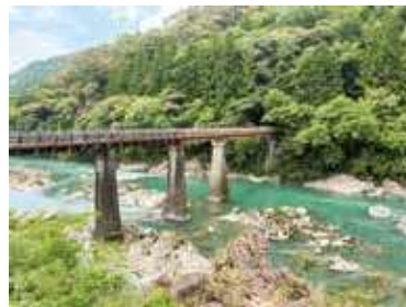
昭和38年の大水害によって 橋脚が破壊された軌道橋
