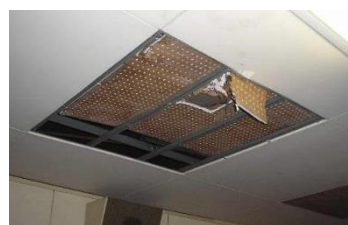
天井材の落下・剥がれ
