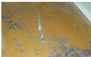
床のひび割れ
