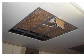
天井材の落下・剥がれ
