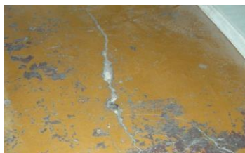
床のひび割れ
