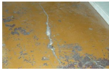
床のひび割れ
