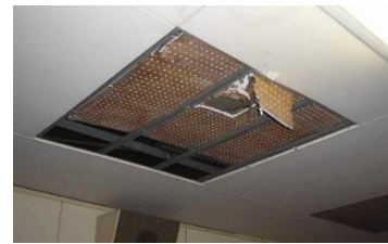
天井材の落下・剥がれ
