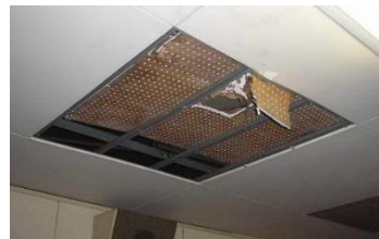
天井材の落下・剥がれ
