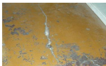
床のひび割れ
