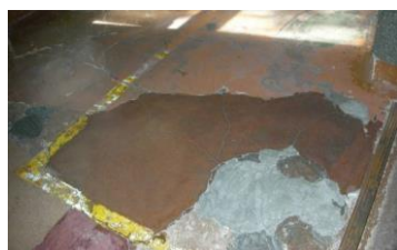
床仕上げの剥がれ
