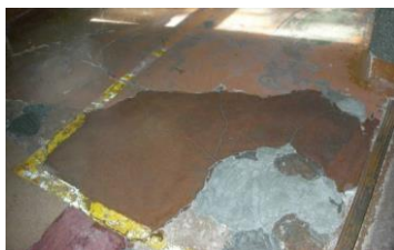
床仕上げの剥がれ
