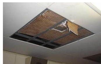
天井材の落下・剥がれ
