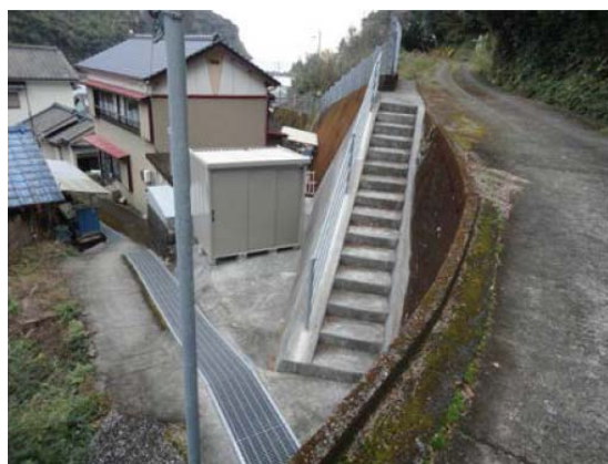
家屋の倒壊が懸念される住宅密集地
