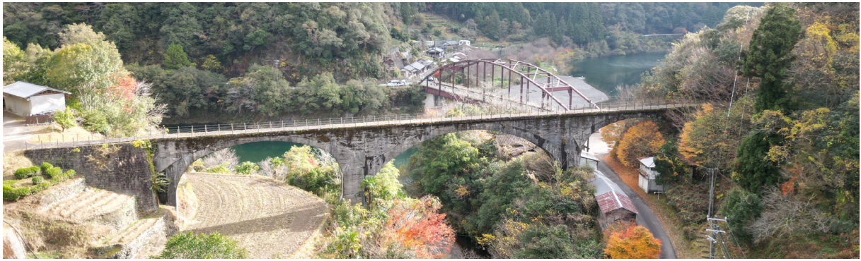
山間に架かる旧森林軌道の橋梁は、森林資源により林業が栄えた歴史を伝える重要な要素である（下津井）
